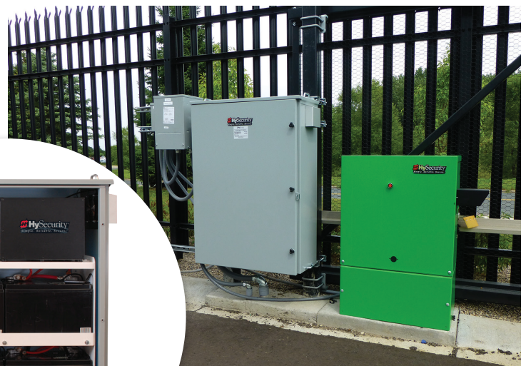
SlideDriver 50VF2/3 en Centro de Datos
